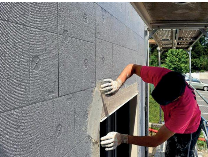
Mise en œuvre des panneaux KNAUF ETIXX ici avec un point singulier angle de baie de fenêtre.
