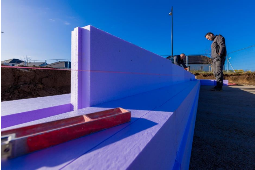
Les blocs de coffrage sont emboîtés au fur et à mesure dans les éléments latéraux spécifiques.
