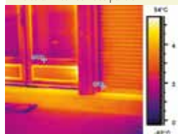
Visualisation par l'extérieur du pont thermique du seuil de porte, des panneaux bois des portes-fenêtres et des joints au pourtour des vitrages. Doc. Recherche « Montholier », FFB/ADEME.
