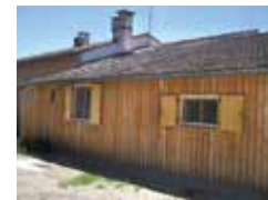
5. Paroi finie en lames de douglas posées verticalement pour améliorer le drainage et la durabilité.
