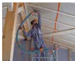
L'insufflation sur membrane d'étanchéité à l'air/frein de vapeur est facilitée si le film est translucide. De plus il doit être très résistant à l'arrachement. Photo B. Joliet.
