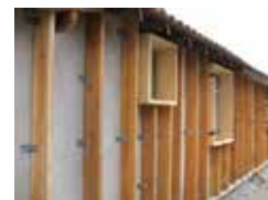
1. Fixation des montants bois et des précadres des menuiseries sur la façade avec platines métalliques.
