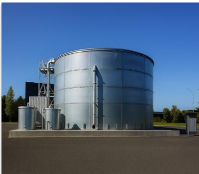
Nouveau système de récupération des eaux de pluie
