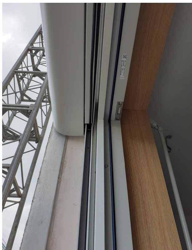
La menuiserie est posée en tunnel, devant les anciens dormants laissés en place afin d'apporter une résistance supplémentaire à l'ensemble. ©Lorillard
