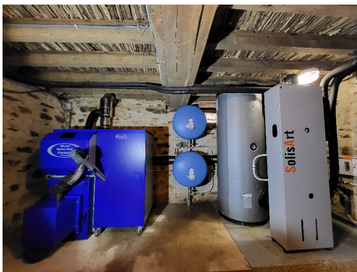
Chaudière à granulés (montage ventouse horizontale) Spira Pell Etanche 9-33kW associée à un système solaire combiné composé de : 25m 2 de capteurs solaires thermiques + ballon ECS de 500L et ballon tampon de 1000L pour stocker l'énergie. Maison de 250m 2 (Mayenne)
