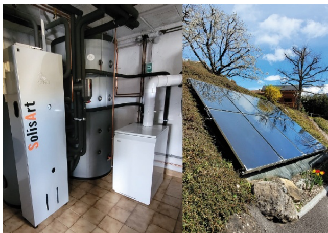
Vortex Utility 18kW en relève de 8 capteurs solaires thermique, chauffage et ECS (Passy 74)
