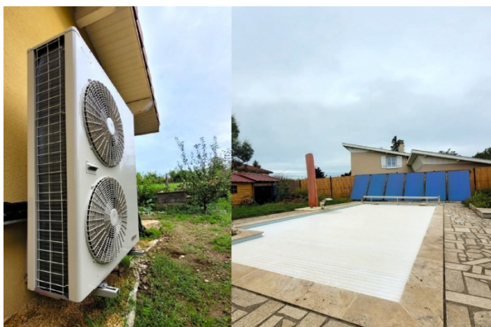
Pompe à chaleur Aérone3 au R32 en relèvement de 6 capteurs solaires - alimente l'ECS, le chauffage et la piscine à Rives (38).
