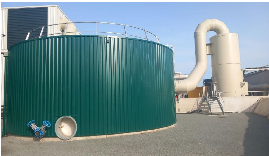
Cuve tampon et tour de désodorisation
