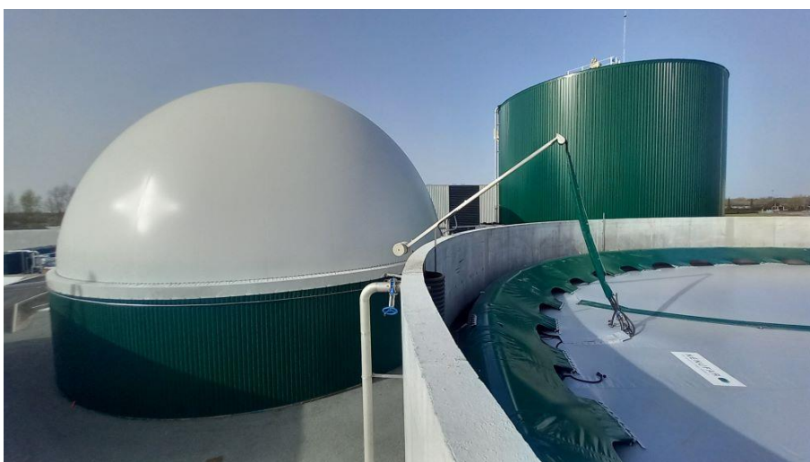
Post-digesteur équipé d'un gazomètre et cuve de stockage de digestat liquide
