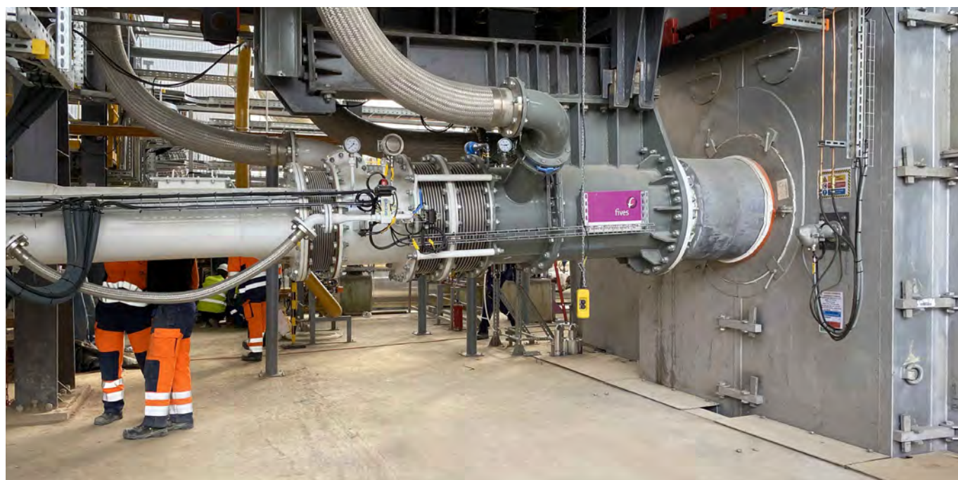
Tuyère du four 6 de la cimenterie d'Airvault : équipement clé assurant une partie de l'apport thermique nécessaire au procédé de fabrication du clinker.
