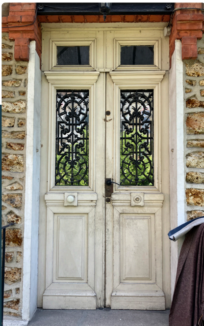
Avant - Porte datant des années 1900 à rénover.
