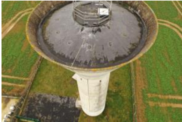
Réserve d'eau difficilement accessible et dangereuse
