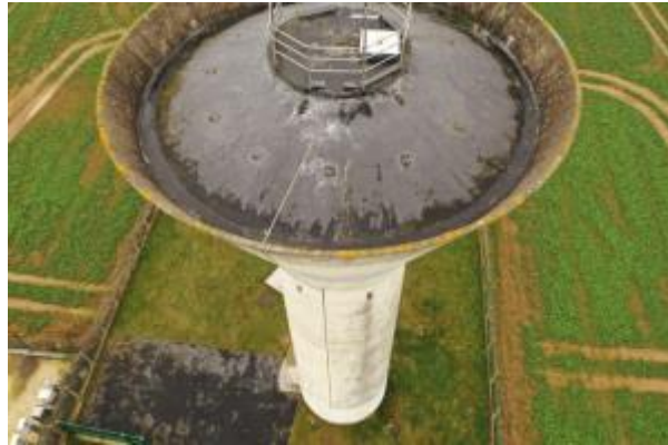
Réserve d'eau difficilement accessible et dangereuse
